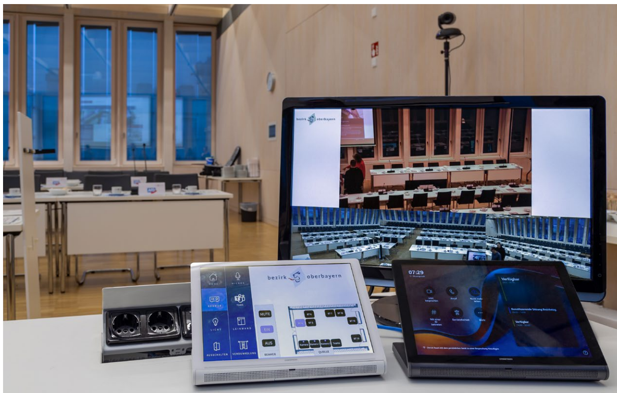
Zwei Touchpanels: Eines für die Steuerung der Medientechnik inklusive Kameras (links), das rechte Panel wird für die Microsoft Teams Rooms (MTR) Bedienung eingesetzt.
